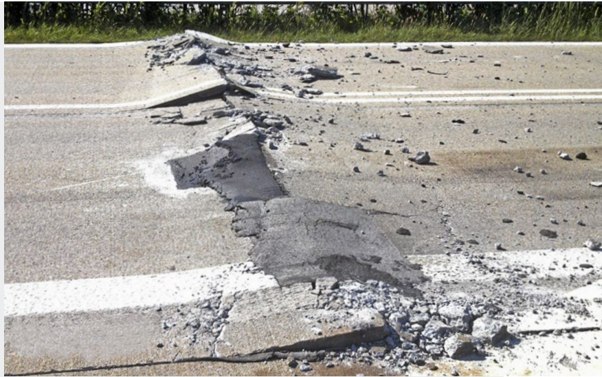
Bei Hitze können Beton-Fahrbahnen plötzlich aufbrechen
